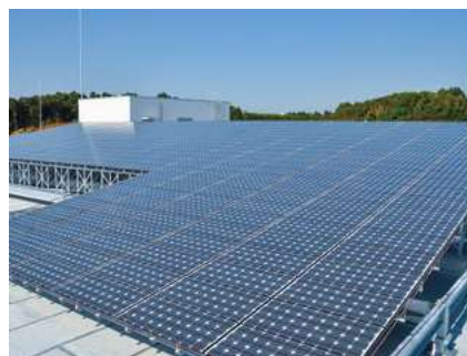
成田ターミナル太陽光発電設備
