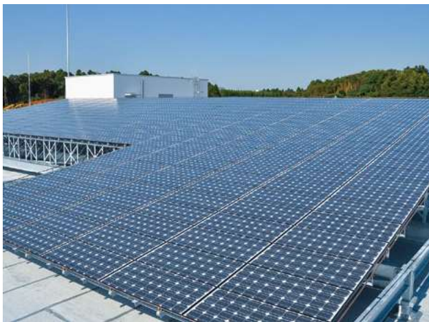
成田ターミナル太陽光発電設備
