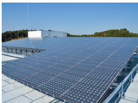
成田ターミナル太陽光発電設備
