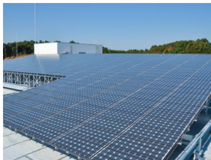
成田ターミナル太陽光発電設備
