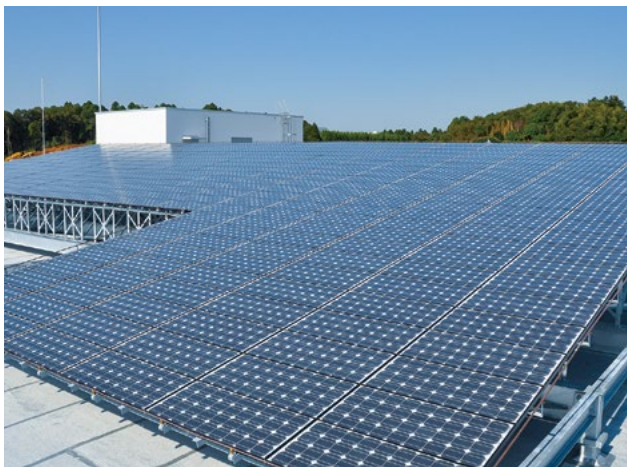
成田ターミナル太陽光発電設備
